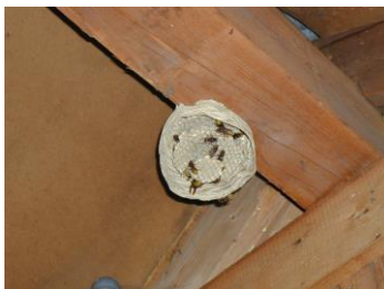
Hornissennest am Dachboden
